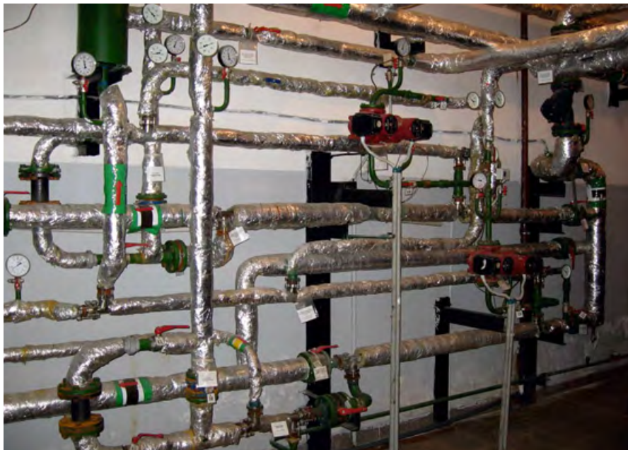
❖ Фото 6. «Планшетный» теплопункт офисного здания
