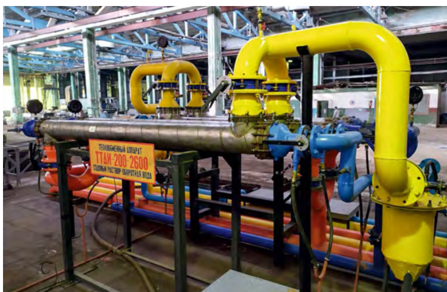
❖ Фото 5. Теплообменные аппараты ТТАИ на Степногорском подшипниковом заводе (Казахстан)
