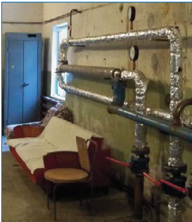
Рисунок 2. Помещение бывшего ИТП, обустроенное для обслуживающего персонала. На стене расположен «планшетный» теплопункт. Хорошо виден основной элемент нового ИТП – теплообменник ТТАИ с показывающими средствами контроля давления и температуры.
