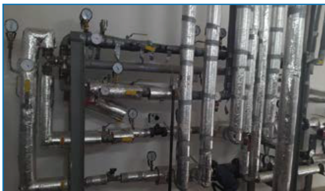
Рисунок 3. «Планшетный» теплопункт в здании Ледовой арены, г. Лыткарино.
