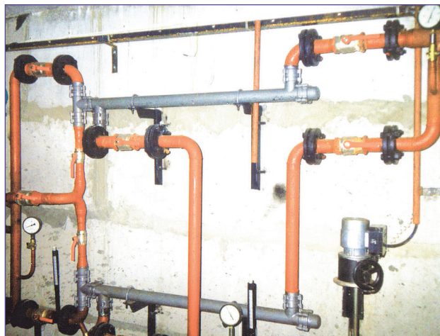
Фото. ИТП одного из промышленных объектов в Воронеже с использованием кожухотрубных теплообменных аппаратов ТТАИ.
